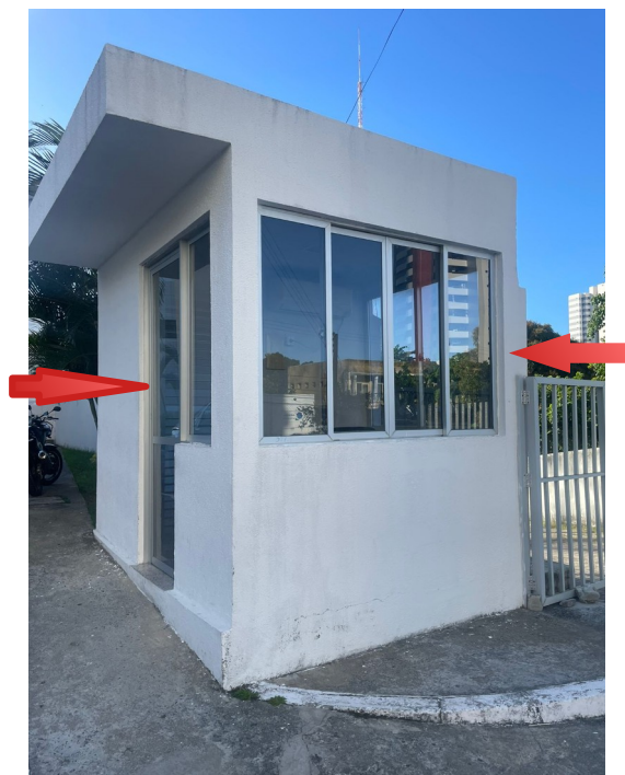
Foto 2: Vista da Guarita com as esquadrias que recebem insolação e receberão Película.
