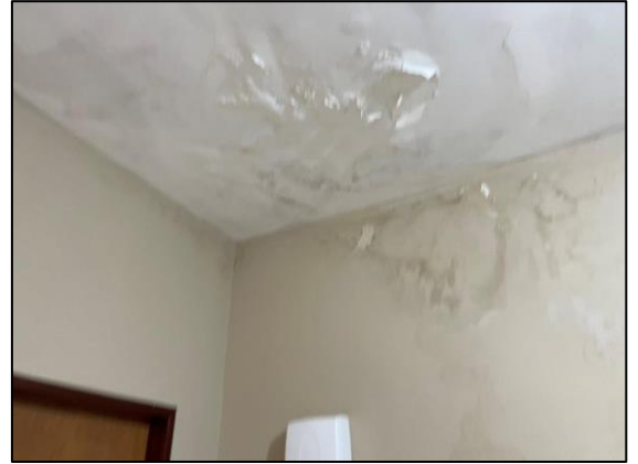
Infiltração de água - Copa/Cozinha
