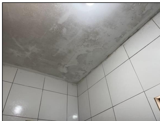
Umidade na laje – BWC Social
