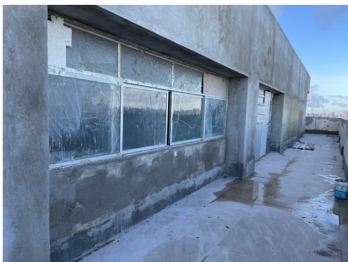
FOTO 10: vista do Terraço (J1)
